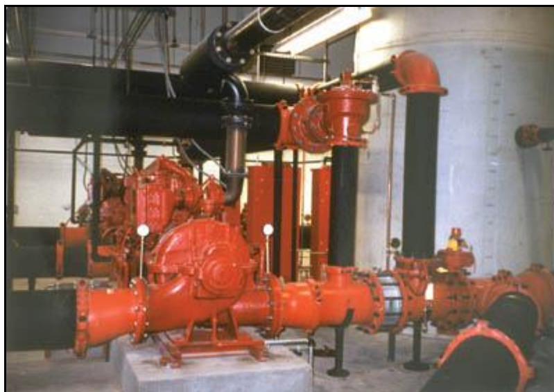
Ejemplo de Sala de Bombas. En primer plano bomba de Cámara Partida impulsada por motor diesel.
