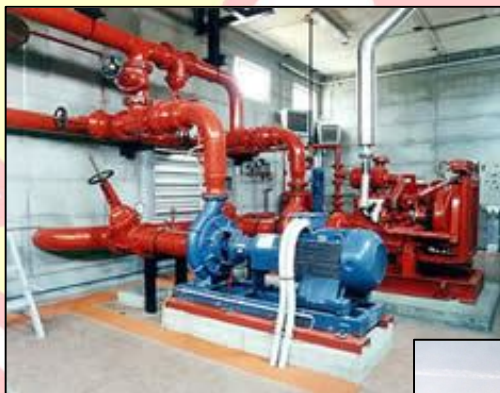
Grupo de Bombeo
