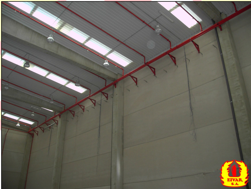
Foto. Instalación tipo de sistema de rociadores
